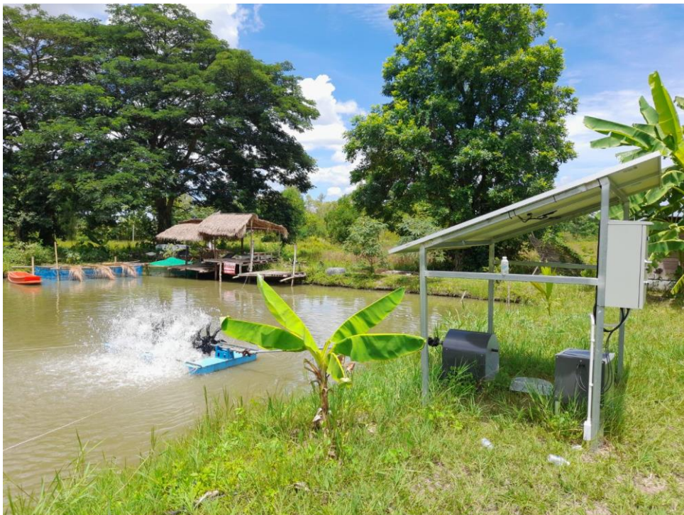
รูปที่ 3 ระบบผลิตไฟฟ้าพลังงานแสงอาทิตย์ที่ติดตั้ง ณ บ่อเลี้ยงปลา
