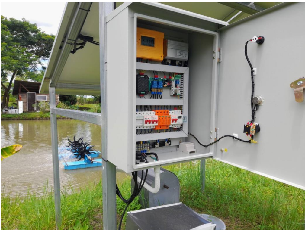
รูปที่ 4 ตู้ควบคุมระบบผลิตไฟฟ้าพลังงานแสงอาทิตย์
