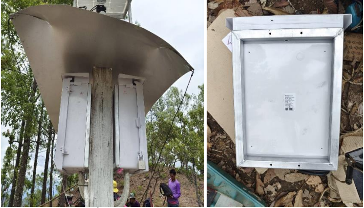
รูปที่ 5.9 การติดตั้งตู้ควบคุมพลังงานแสงอาทิตย์และโหนดเซ็นเซอร์
