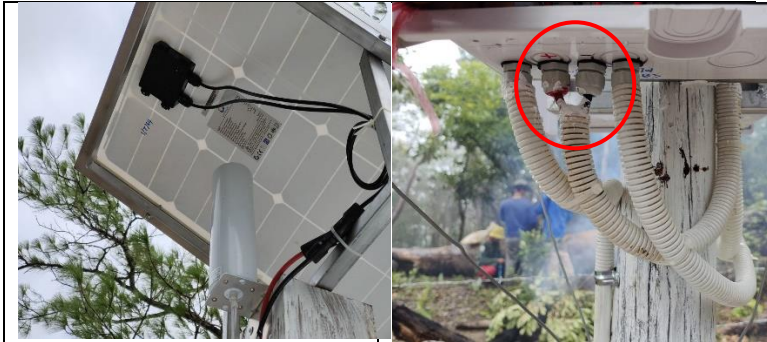
รูปที่ 5.8 การเชื่อมต่อแผงฯ กับตู้ควบคุมพลังงานแสงอาทิตย์
