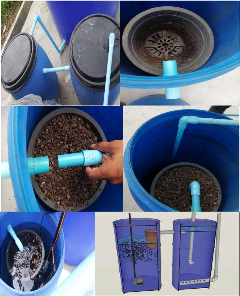
รูปที่ 5.5 การติดตั้งถังกรองชีวภาพและปั้มน้ำ
