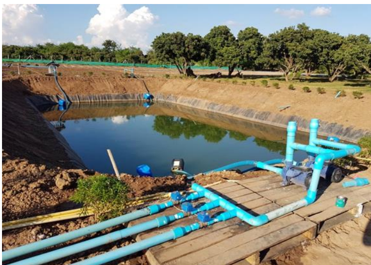
ภาพแสดง การเดินท่อส่งน้ำจากบ่อเก็บเข้าสู่ระบบปั๊มอัตโนมัติ
