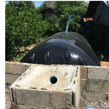
ภาพที่ ๑๐ บ่อก๊าซที่ติดตั้งเรียบร้อยแล้ว พร้อมใช้งาน
