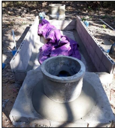
รูปที่ 17 แสดงบ่อเติมและบ่อล้น
