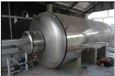
ถังเก็บน้ำร้อนแบบนอน
