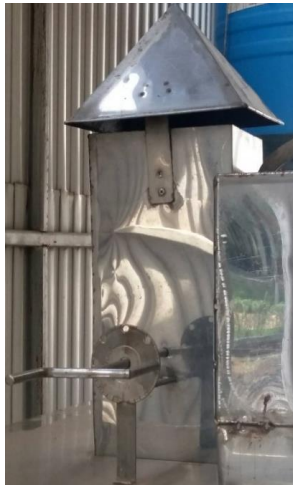
รูปที่ 10 ปล่องและพัดลมระบายความชื้น
