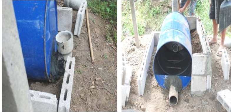
ภาพที่ 5 การต่อท่อด้านหน้าและด้านหลังเตา
