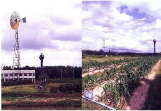
ภาพที่ 3.2 ระบบสูบน้ำด้วยกังหันลม
