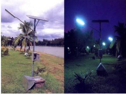
ภาพที่ 3.4 ระบบแสงไฟถนนด้วยเซลล์แสงอาทิตย์
