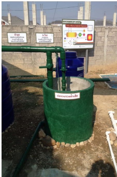
รูปที่ 6.2 ปอร์รวบรวมน้ำเสีย
