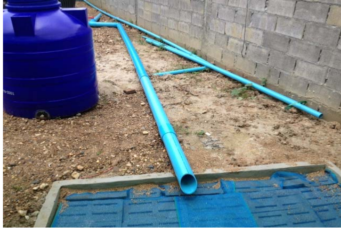
รูปที่ 5.6 การปล่อยกากจากบ่อล้นไหลไปตามท่อ
