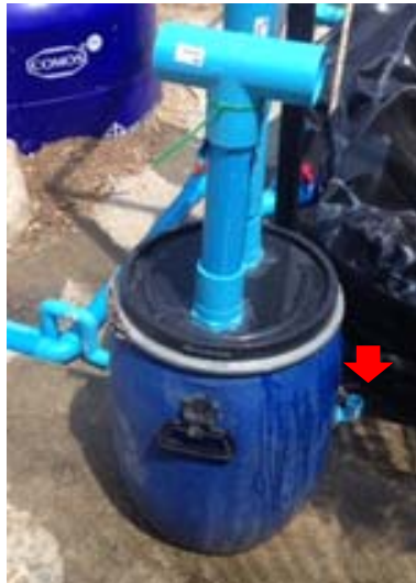
รูปที่ 8.3 การบำรุงรักษาชุดควบคุมแรงดัน
