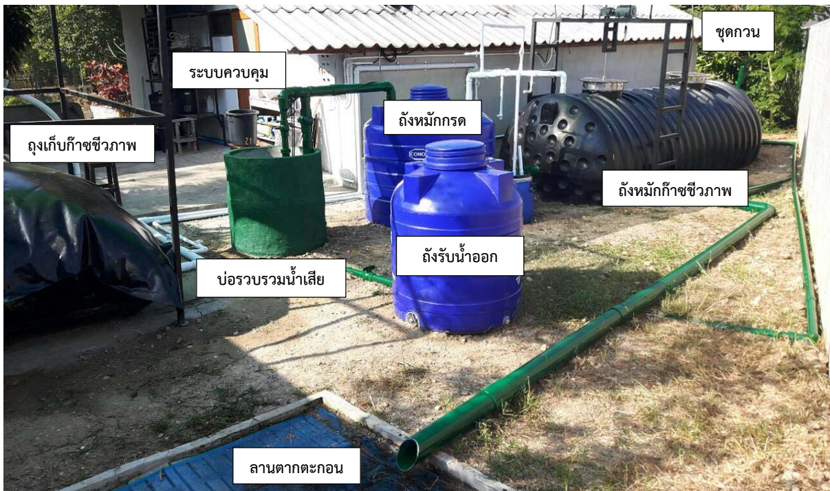
รูปที่ 6.1 ระบบ CMU-Micro Hybrid Digester
