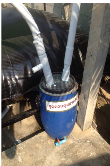
รูปที่ 6.8 ชุดควบคุมแรงดัน
