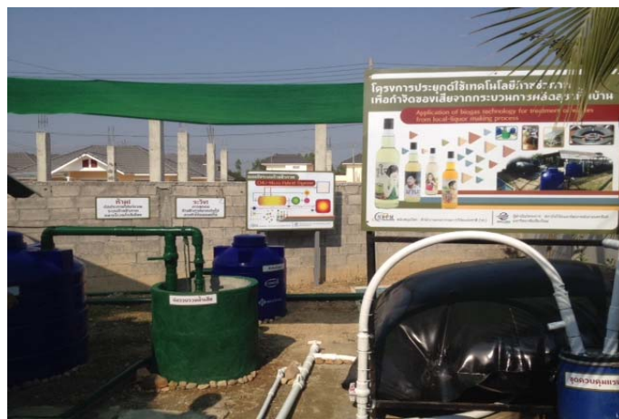
รูปที่ 8.1 การใช้งานบ่อรวบรวมน้ำเสีย
