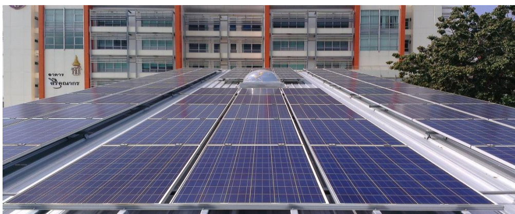
รูปที่ 1.8 แสดงภาพแผง PV module-Polycrystalline ที่ติดตั้งใช้งานในอาคาร
