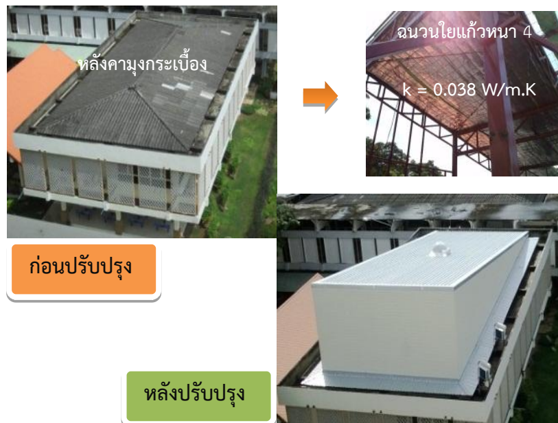
รูปที่ 1.3 แสดงหลังคาอาคารก่อนและหลังการปรับปรุง
