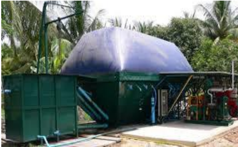
ภาพที่ 9 ตัวอย่างโรงไฟฟ้าขนาดเล็ก
