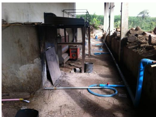
ท่อนำก๊าซชีวภาพไปใช้งานหลังเตาหมัก
