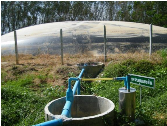
ท่อส่งก๊าซไปหลังเตาหมayang
