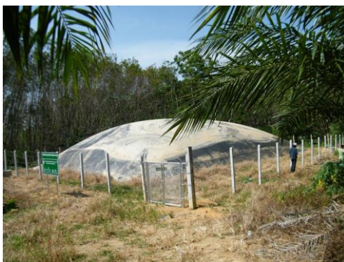
บ่อบำบัดน้ำเสีย
