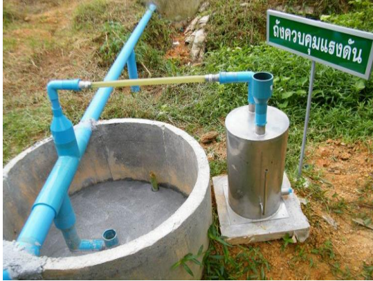
ระบบความปลอดภัยในการนำก๊าซชีวภาพไปใช้ประโยชน์ (ถังควบคุมแรงดันและจุดตัดก๊ำ)
