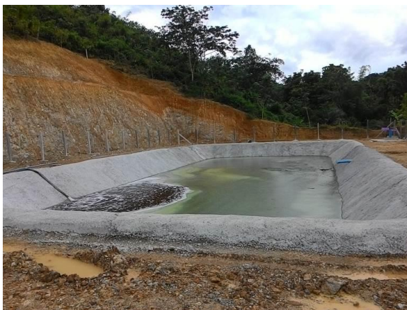
ตุนน้ำเสียเข้าบ่อหมักก๊าซชีวภาพ
