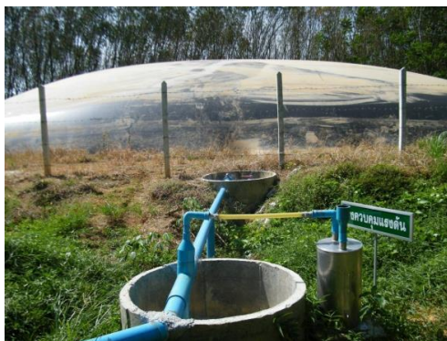
แนวท่อก๊าซชีวภาพ และระบบความปลอดภัย
